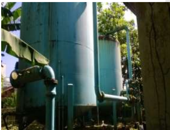
Figura 5. Estação de tratamento: filtração. Fonte: (os autores).
