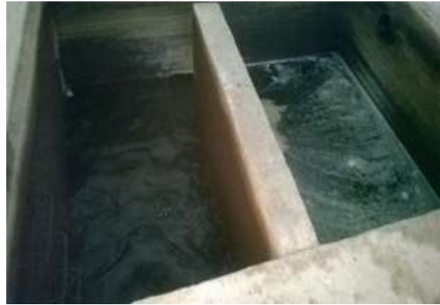
Figura 4: Estação de tratamento com sulfato de Alumínio.
