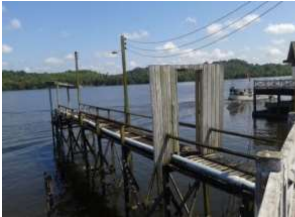
Figura 3: Elevatória de Oiapoque. Fonte: (os autores).
